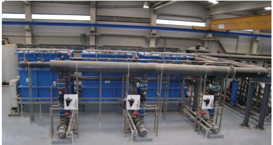
Figura 4. Vista de los 3 trenes de membranas de ultrafiltración
