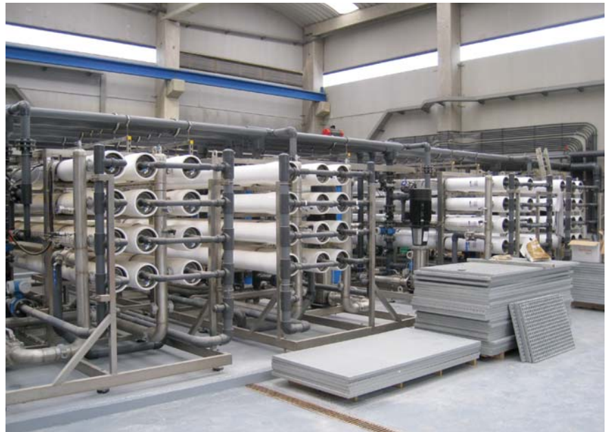
Figura 6. Detalle de los 4 bastidores de ósmosis inversa
