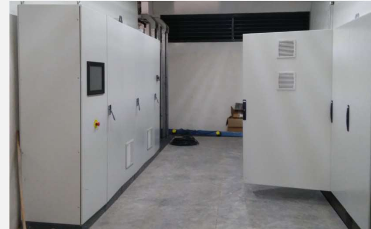
En edificio de tratamiento regeneración de agua mediante membranas
